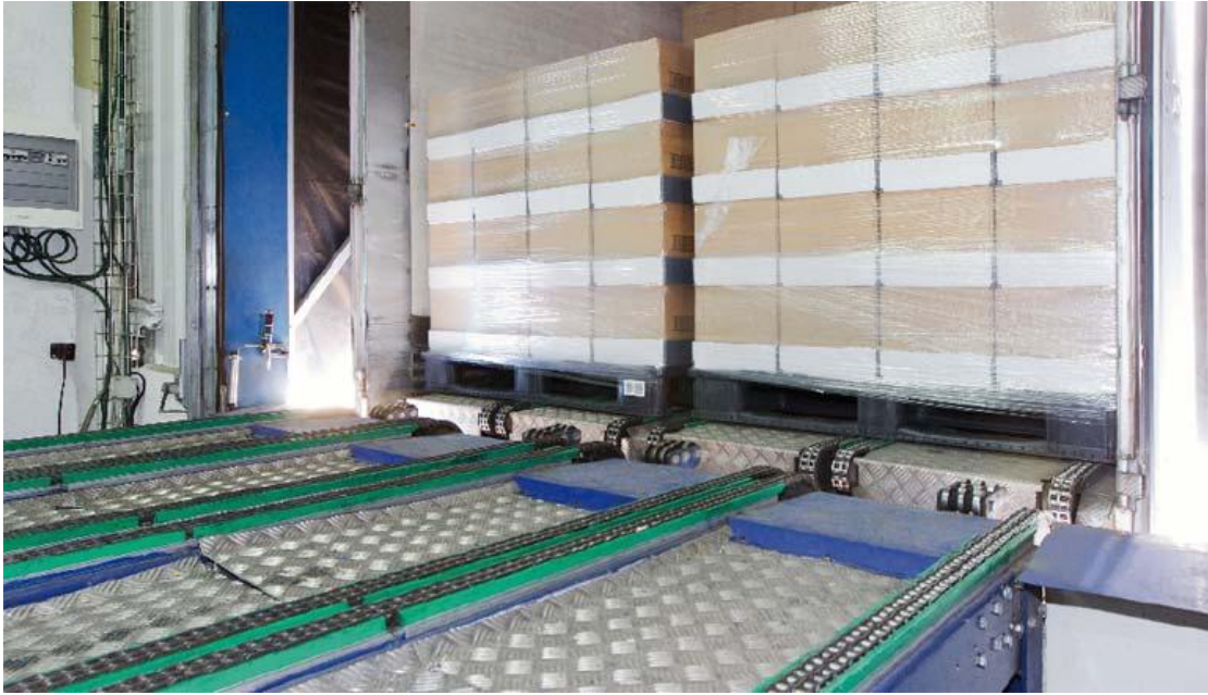
17 - IMAGEN DE RAMPA MODULARES FIJAS PARA CARGA/DESCARGA DE MERCADERÍAS ADOSADAS AL MUELLE
