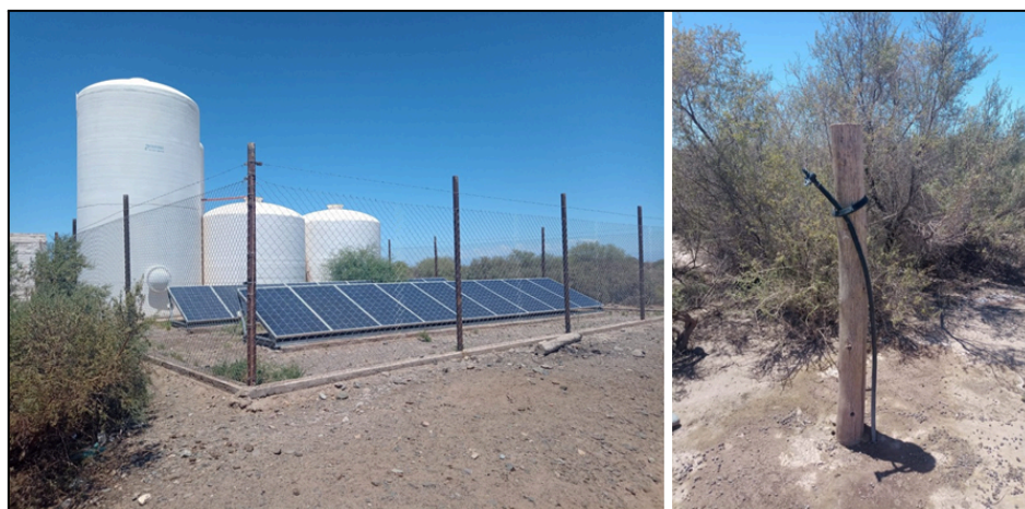
Figura 7: Acueducto del Desierto: estación presurizadora y surtidor domiciliario
