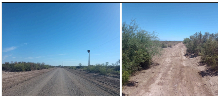
Figura 9: Imágenes del estado de enripiado a la Capilla y huellas
